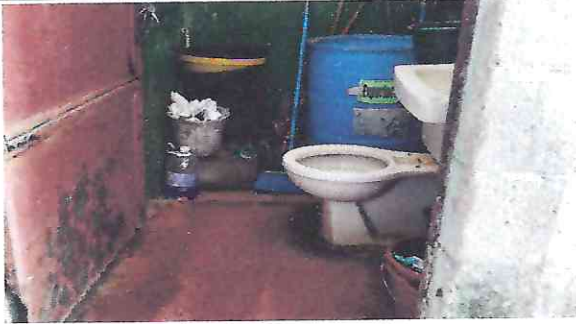
Foto 5: Servicios sanitarios en mal estado
