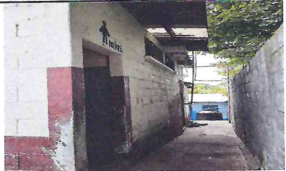
Foto 4: Pintura de algunas paredes en mal estado
